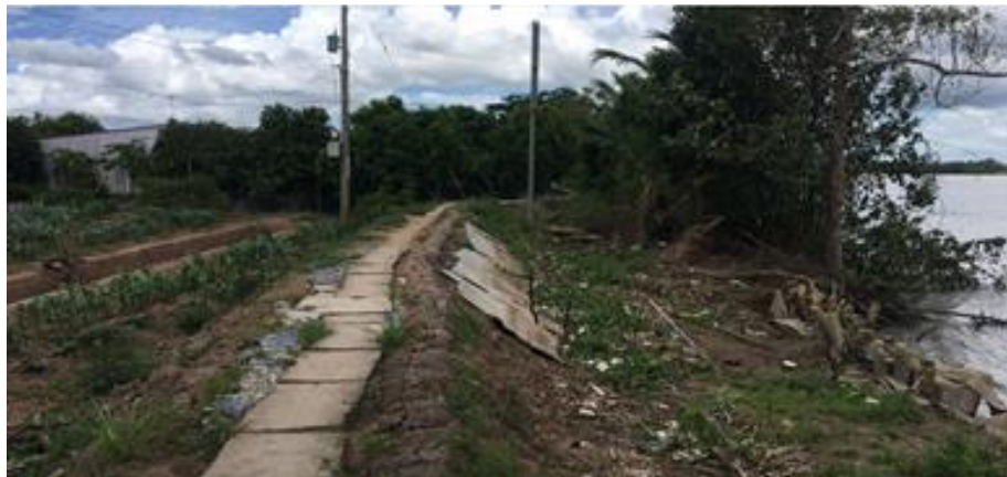
Ảnh 36: Sạt lở bờ sông Hậu thuộc xã Hòa Tân
